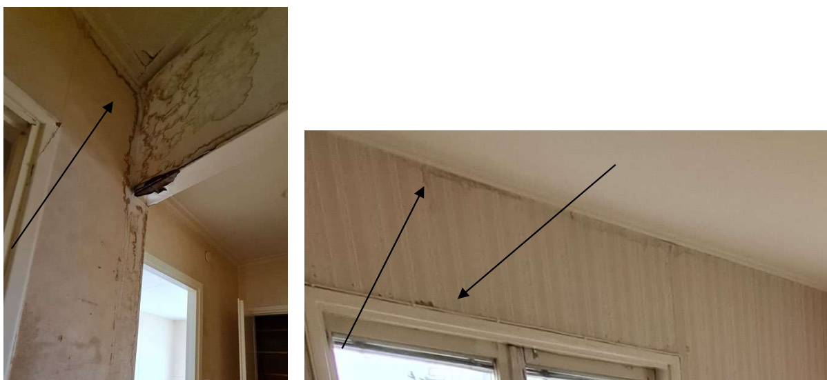
Bild 11 Noterade fuktanvisningar i lägenhet på våning två.
