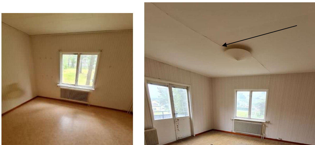
Bild 12 Lägenhetsrum samma lägenhet som ovan, spricka i tak.
